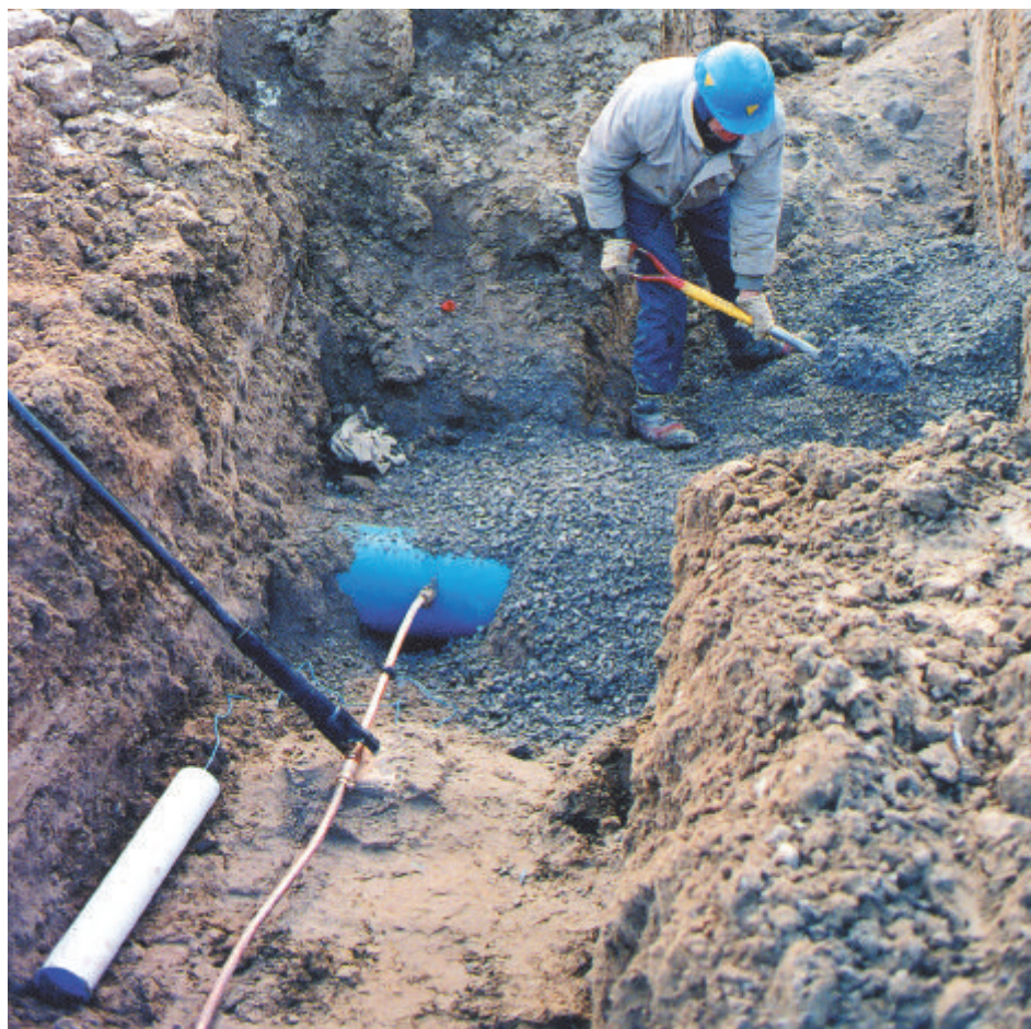
Remblayage d'un aqueduc souterrain. Photo montrant la conduite principale, la conduite d'approvisionnement en eau, l'anode et la soupape d'arrêt de service.
