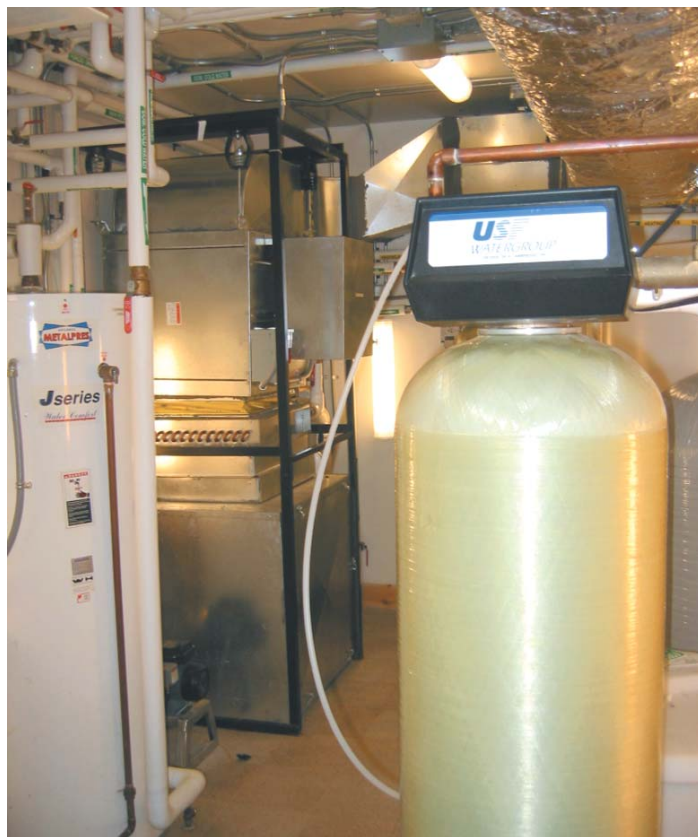
Le cuivre : élément de première importance dans la conception et la pose du système de distribution d'eau et du système de refroidissement.
