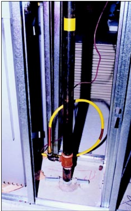
La conduite d'alimentation de gaz naturel en cuivre est reliée à la conduite principale en acier à l'aide d'un raccord en laiton évasé.
